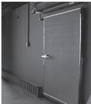
新たに設置された冷凍機
