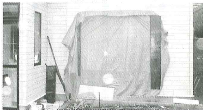
▼飛散物で住家の壁がやぶられる
