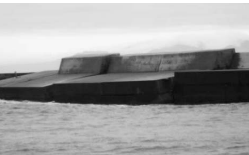
4月の低気圧で倒壊した防波堤
