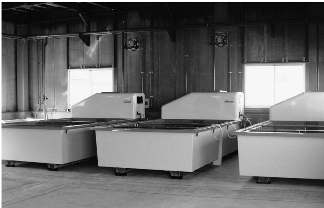
▲荷捌き施設内の畜養施設
